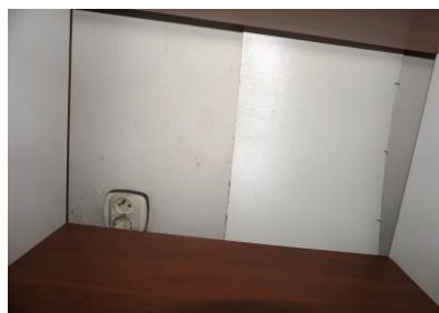
pohled za kuchyňskou linku – dole, vlevo od zásuvky - stopy vlhkosti
