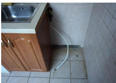
prostor za sporákem – vodovodní potrubí
