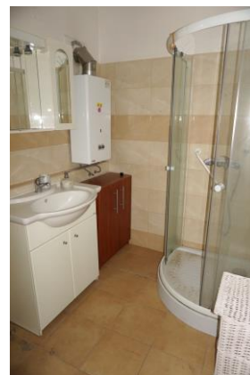
koupelna - vlevo vedle sprchového koutu odchlípnutá dlažba
